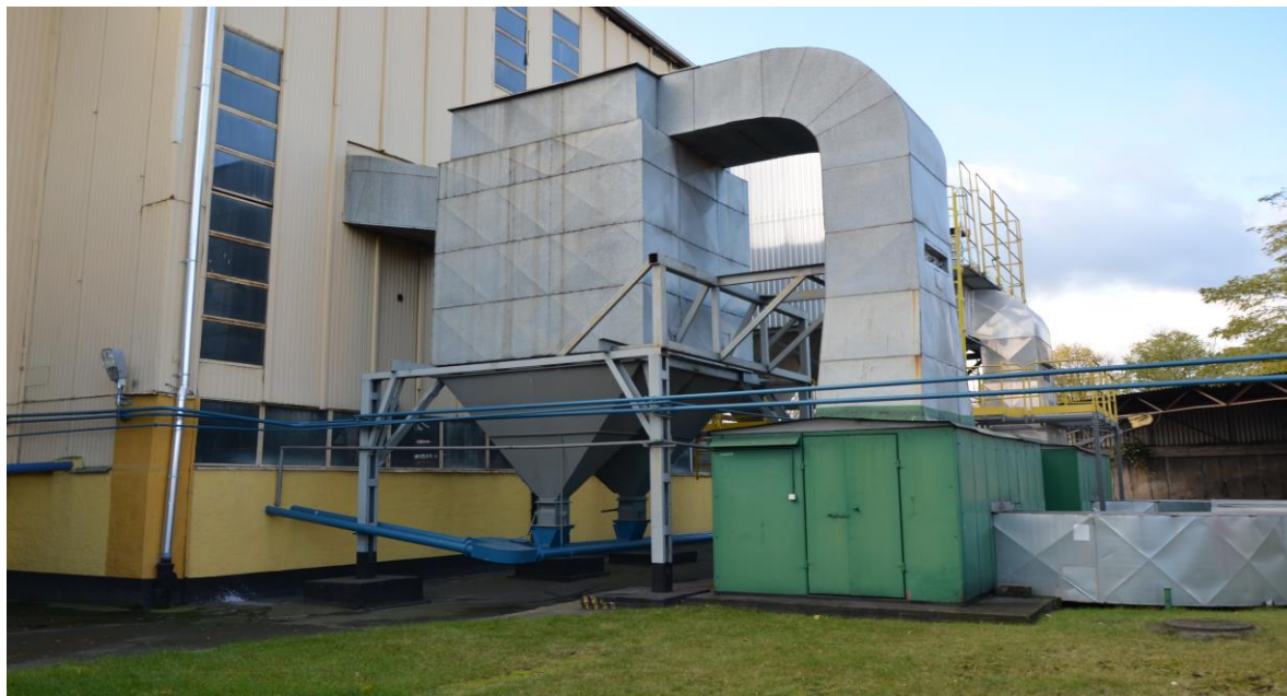
Istniejąca instalacja wyciągu spali kotła WR-10
