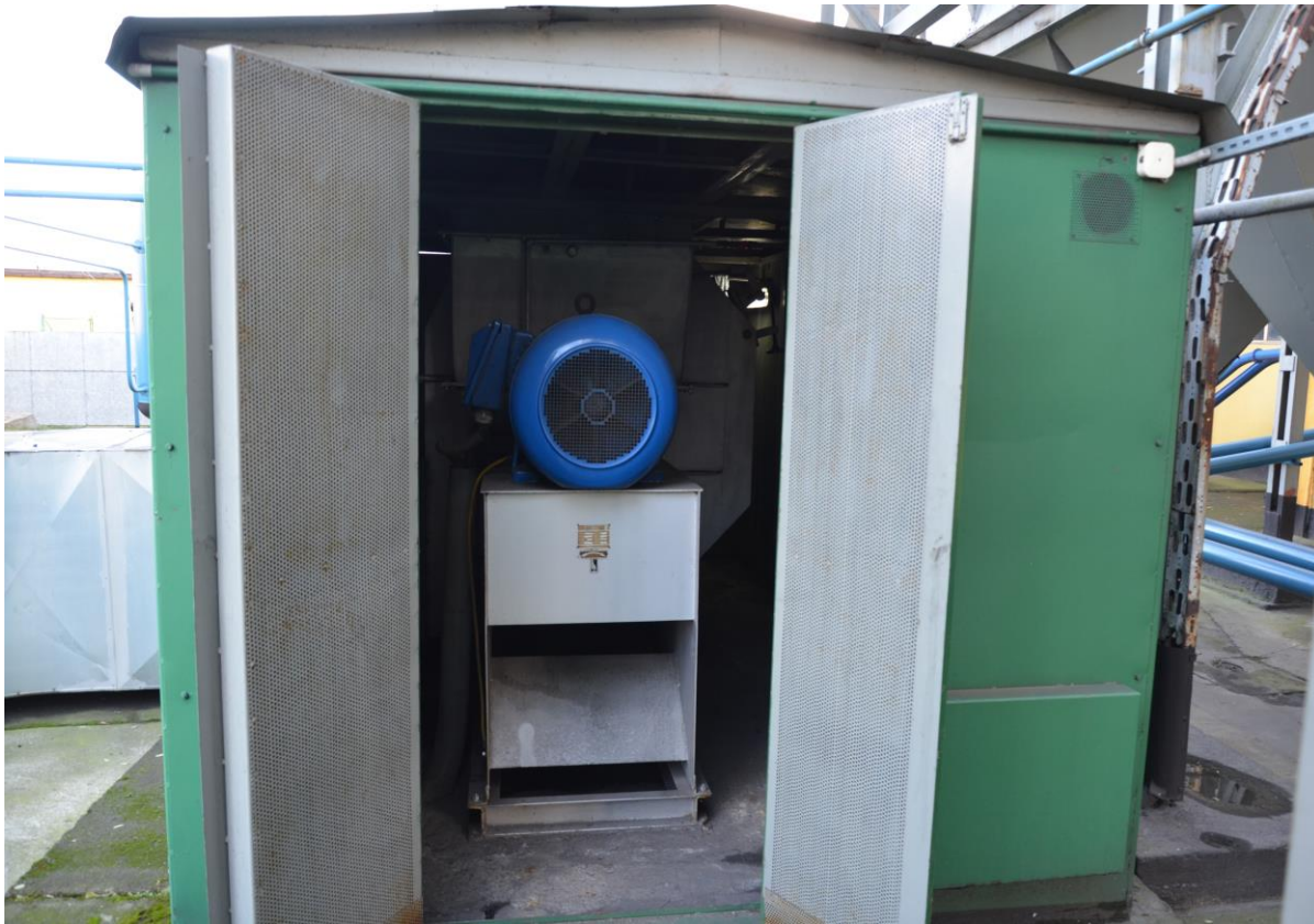
Istniejący wentylator wyciągu spalin WPWDs-55/1,8 A+K w zabudowie dźwiękochłonnej
