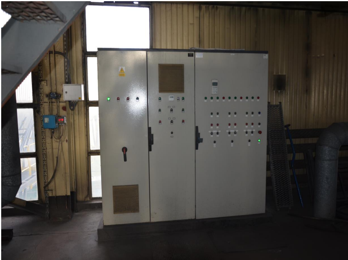
Szafa silnoprądowa kotła WR-10-011
